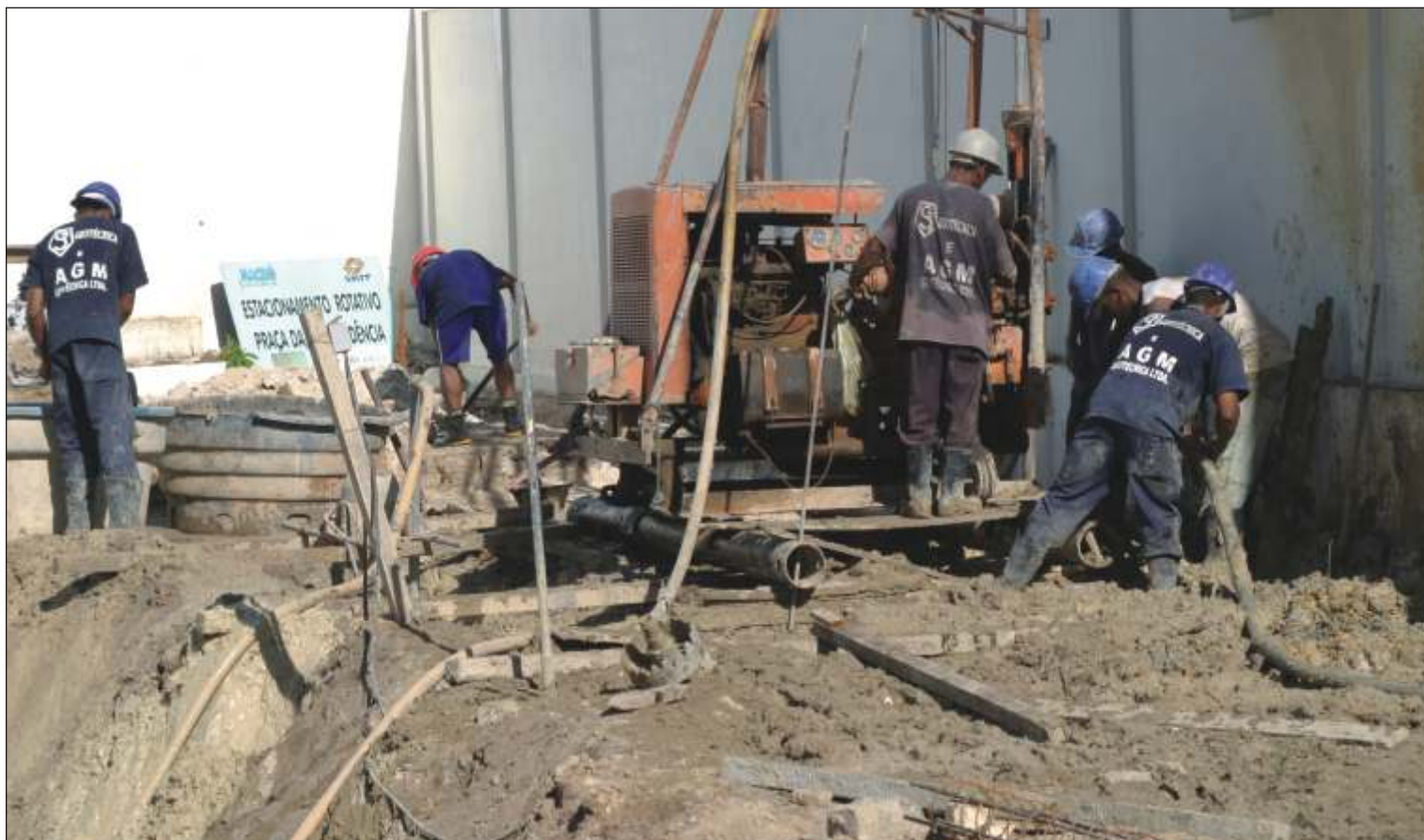
Operários da construção civil trabalham a todo vapor para cumprir rigorosamente os prazos e entregar a obra até 31 de dezembro próximo
